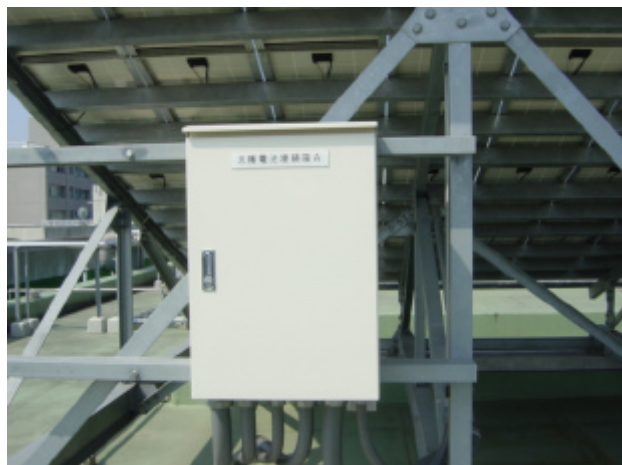
屋上の接続箱（集電箱）
