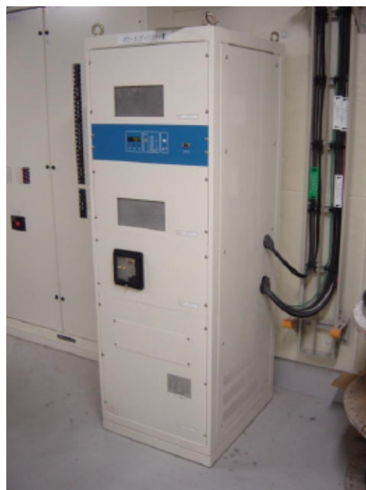
パワーコンディショナー（電気室）
