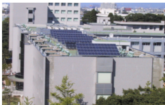
右は拡大写真 太陽光を受ける太陽光発電モジュール
