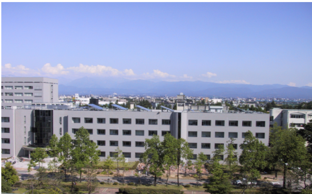
2号館屋上に設置された太陽光発電モジュール，5基の太陽電池アレイ
