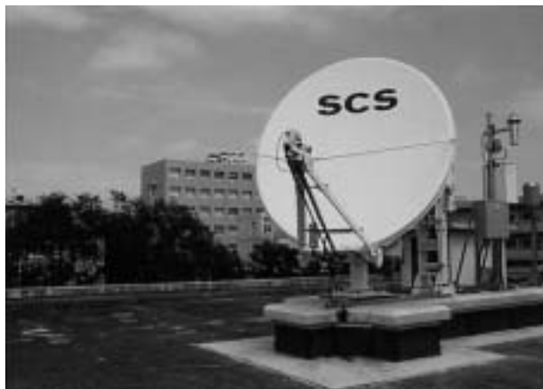
SCSパラボラアンテナ（平成11年4月）
