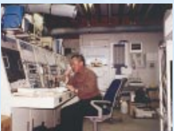
昭和基地管理棟の通信室
