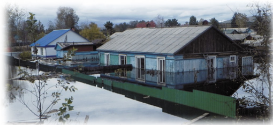
写真 1. 床上浸水した家屋。アムール州ゼーヤの町にて (写真提供: Lisovsky Viktor Viktorovich)
