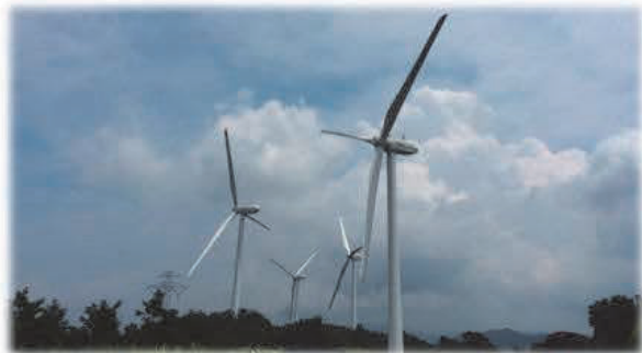
写真1. 和歌山県における風力発電所設備 (撮影:宮本)
